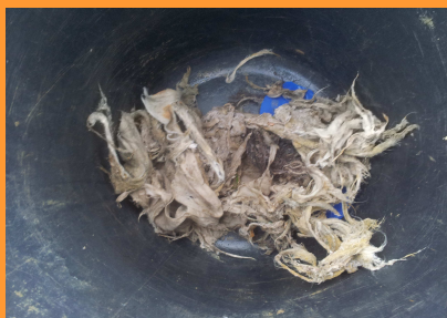
Serpillère bloquant une pompe d'assainissement du réseau
